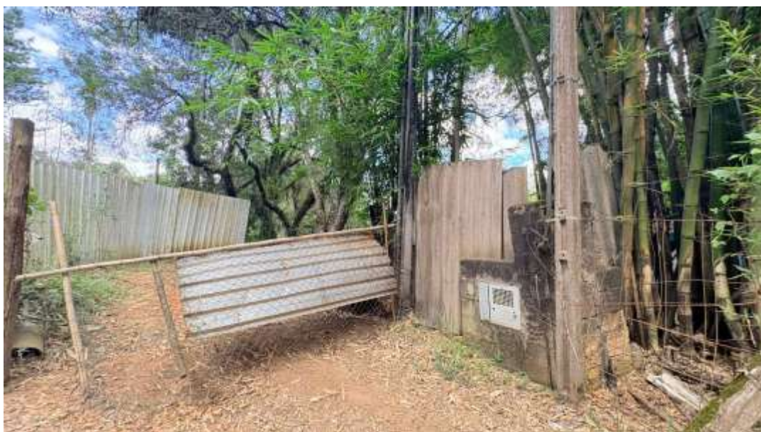
Foto 06 – Entrada de energia
