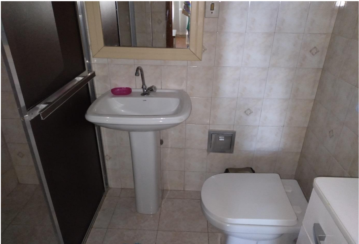
FOTO 09 – Vista parcial interna do estado do imóvel avaliando (banheiro social).
