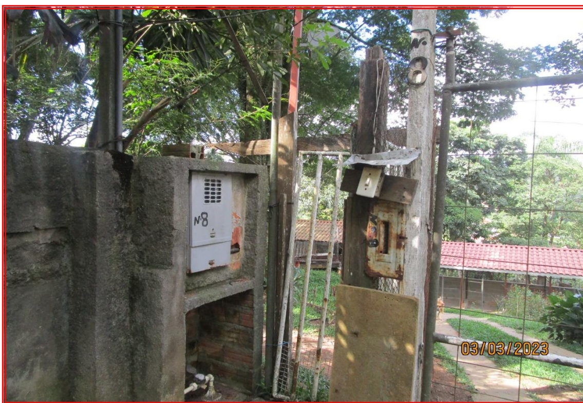
Foto nº 09: Vista dos padrões de entrada de energia elétrica e água potável, onde se pode observar a numeração predial “8” de identificação do imóvel.
