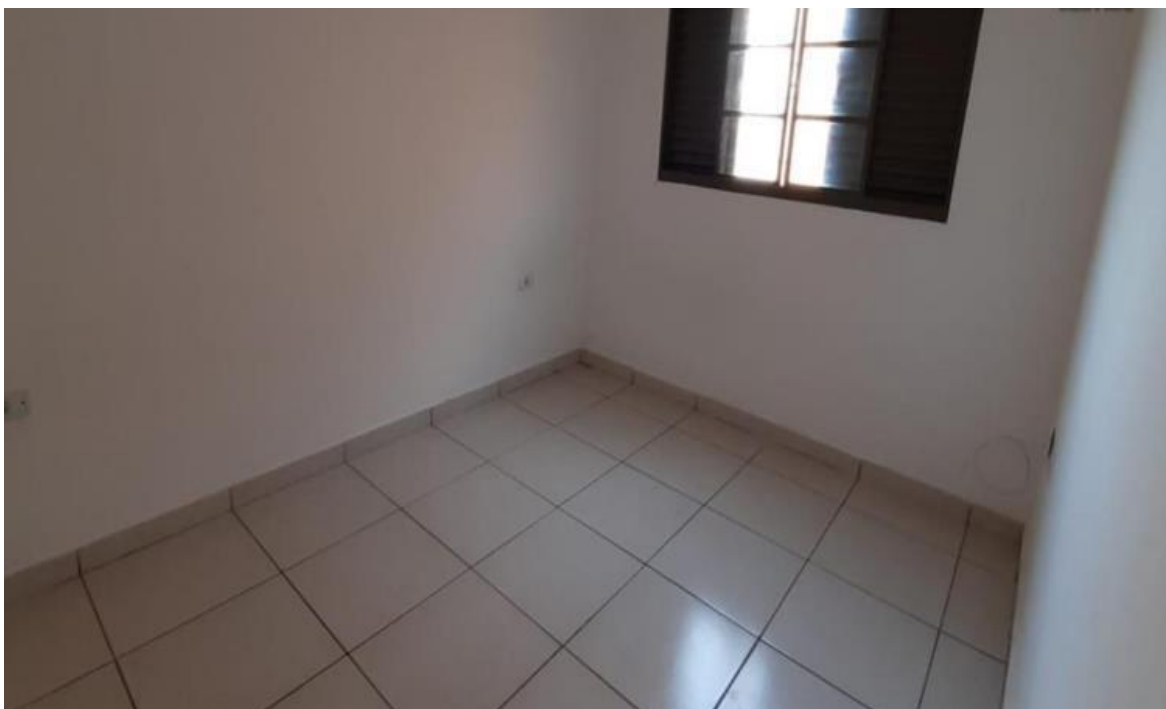
Imagem 06 – O outro Dormitório existente no Apartamento - piso cerâmico, esquadria em metal, instalação elétrica embutida e Pintura sobre massa corrida, bom padrão construtivo.
