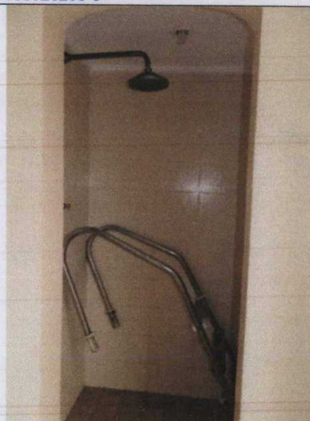
Foto 18 – Chuveiro da piscina.
