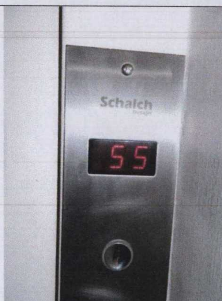
Foto 24 – Elevador social atual marca "SCHALCH".
