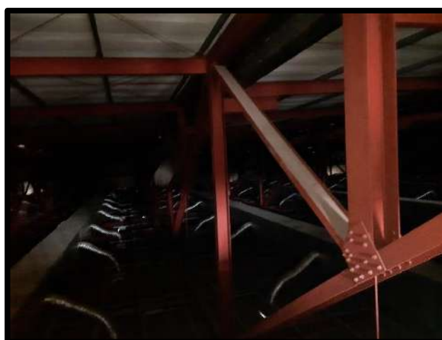
FOTO 41 - VIGAS E SISTEMA DE AR CONDICIONADO
