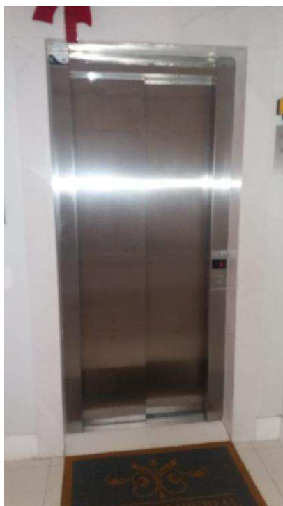
FOTO 03 – ELEVADOR SOCIAL QUE ATENDE AO BLOCO “B”
