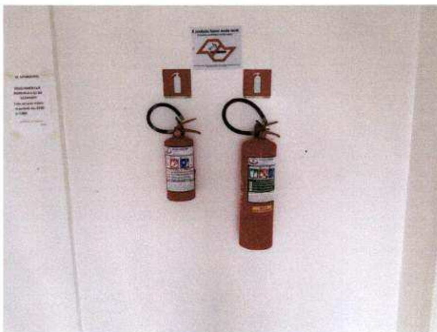
9- Sistema de combate a incêndio
