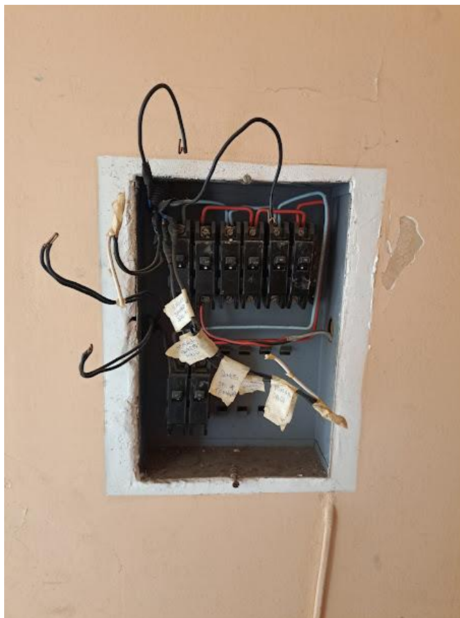
FOTO 27: Quadro de energia (Fora de Norma).
