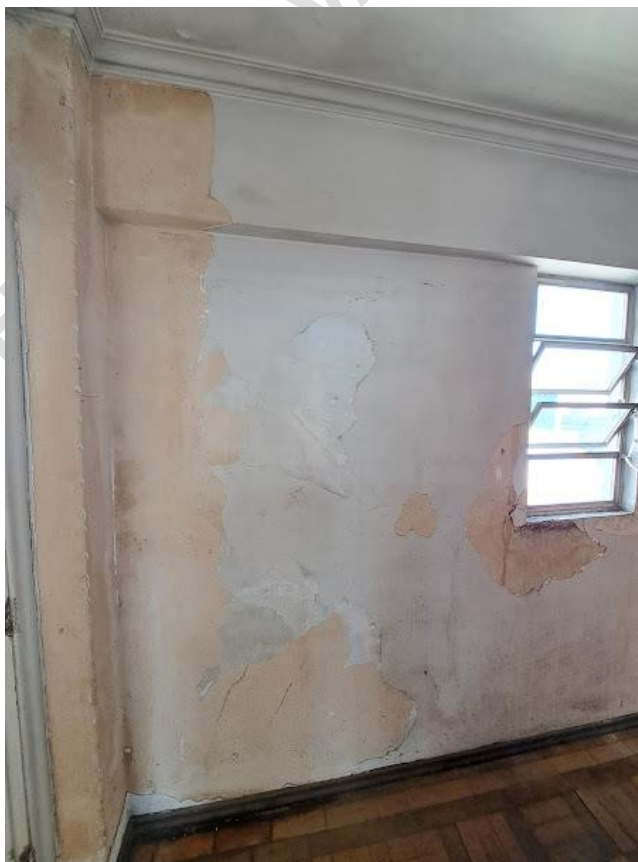
FOTO 22: Situação da parede do corredor de acesso aos dormitórios.
