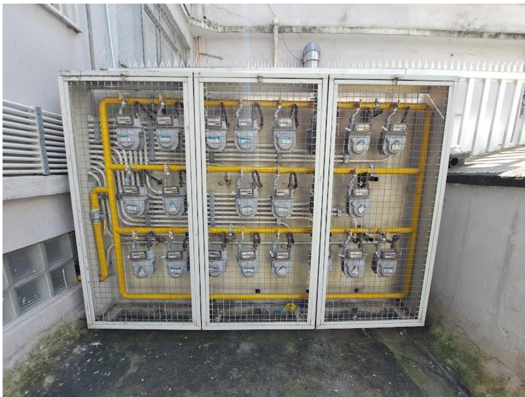
FOTO 04: Quadro medido Gás Natural.
