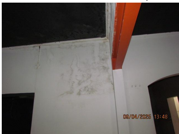
Paredes com manchas de infiltração
