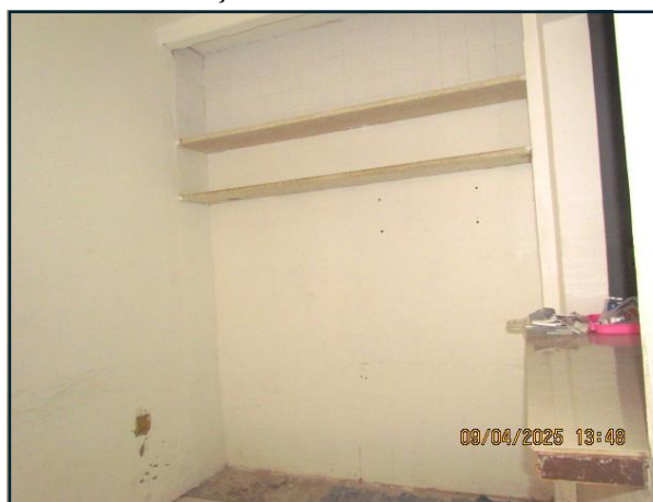
instalação elétrica danificada
