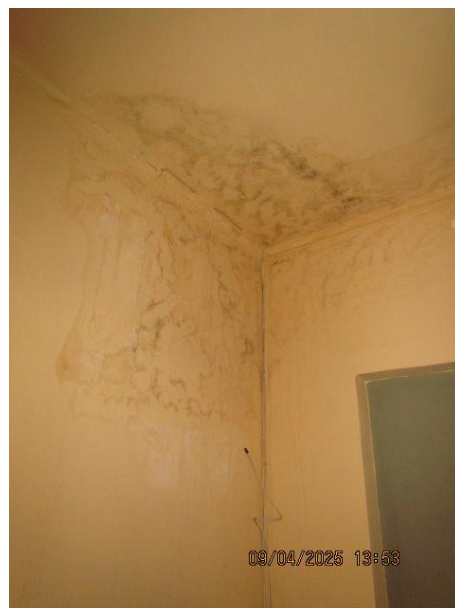
teto e parede com manchas de infiltração com pintura danificada
