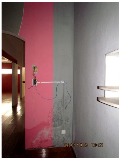
Vista de parede danificada com retirada de instalação elétrica
