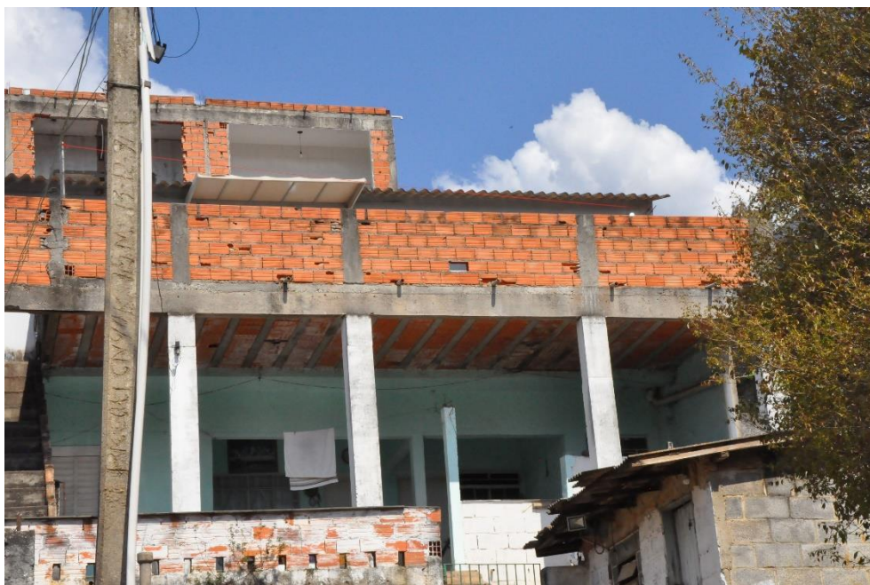
Figura 6. Na presente avaliação foram considerados o tipo construtivo, o estado da edificação e a idade construtiva de 14 anos, pois as alterações finalizaram em 2011.
