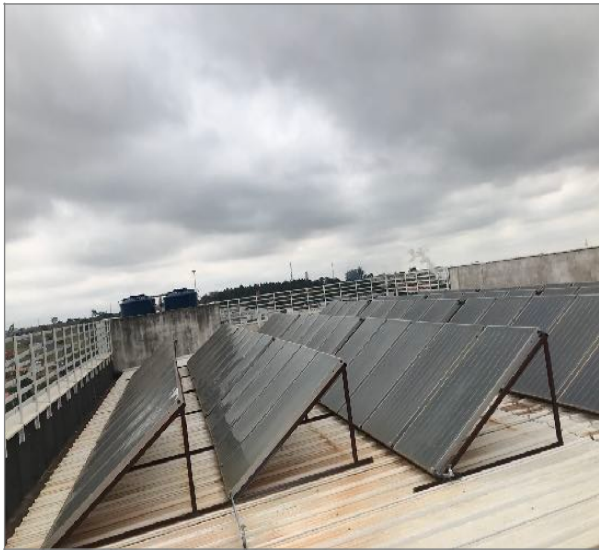
Imagem 23 – Ilustra placas solares do sistema de aquecimento solar.
