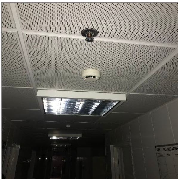
Imagem 13 – Ilustra tipo forro utilizado na área restrita a funcionários e sistema contra incêndio.
