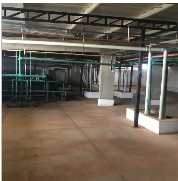
Imagem 21 – Tomada fotográfica obtida da área técnica. Detalhe para sistema de agua quente (tubulação verde).
