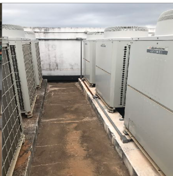
Imagem 22 – Tomada fotográfica obtida da cobertura, ilustrando parte do sistema de ar condicionado.
