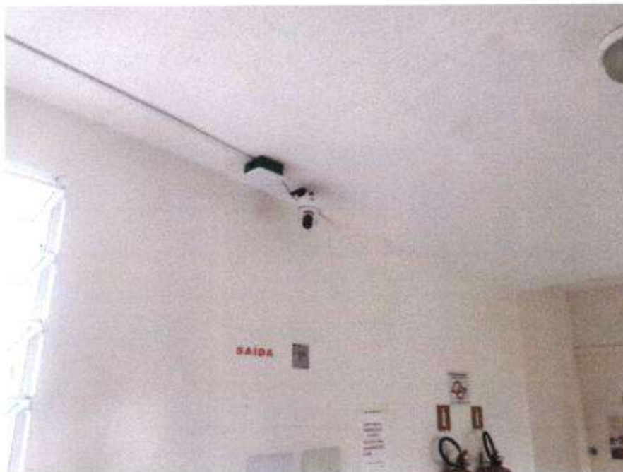
10- Sistema de monitoramento e segurança
