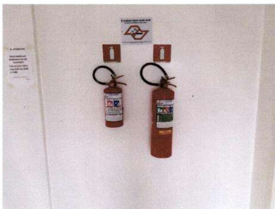
9- Sistema de combate a incêndio
