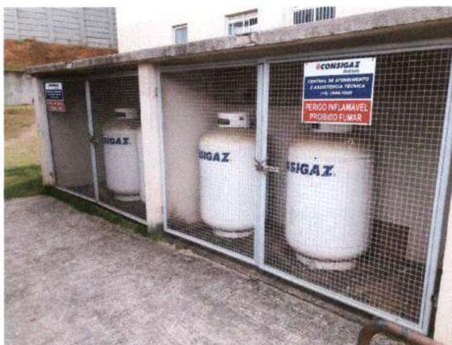
11- Bateria de GLP
