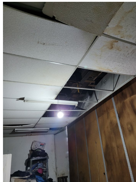
Teto sinais de infiltração (águas pluviais)
