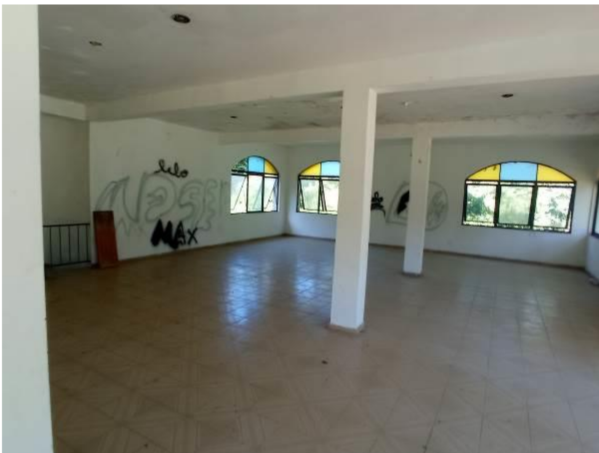
Foto 9: Interior do salão de festas abandonado
