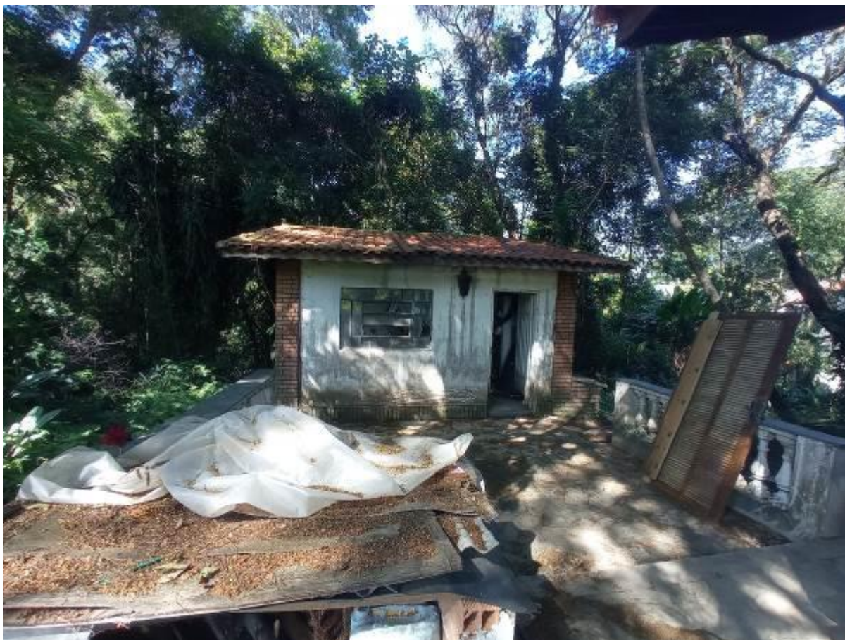
Foto 6: Vista do pequeno depósito em ruínas
