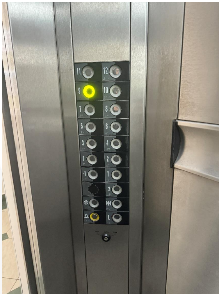
Foto 6: Vista do elevador
