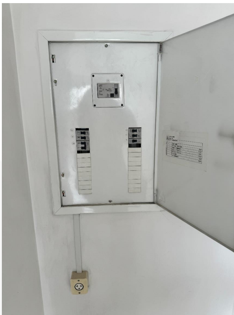
Foto 16: Quadro de luz da sala comercial
