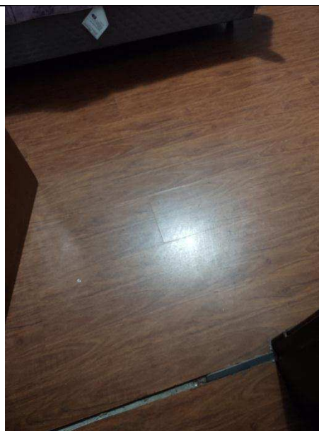
Foto 28 – Detalhe de pisos quentes dos dormitórios e sala (carpete de madeira).
