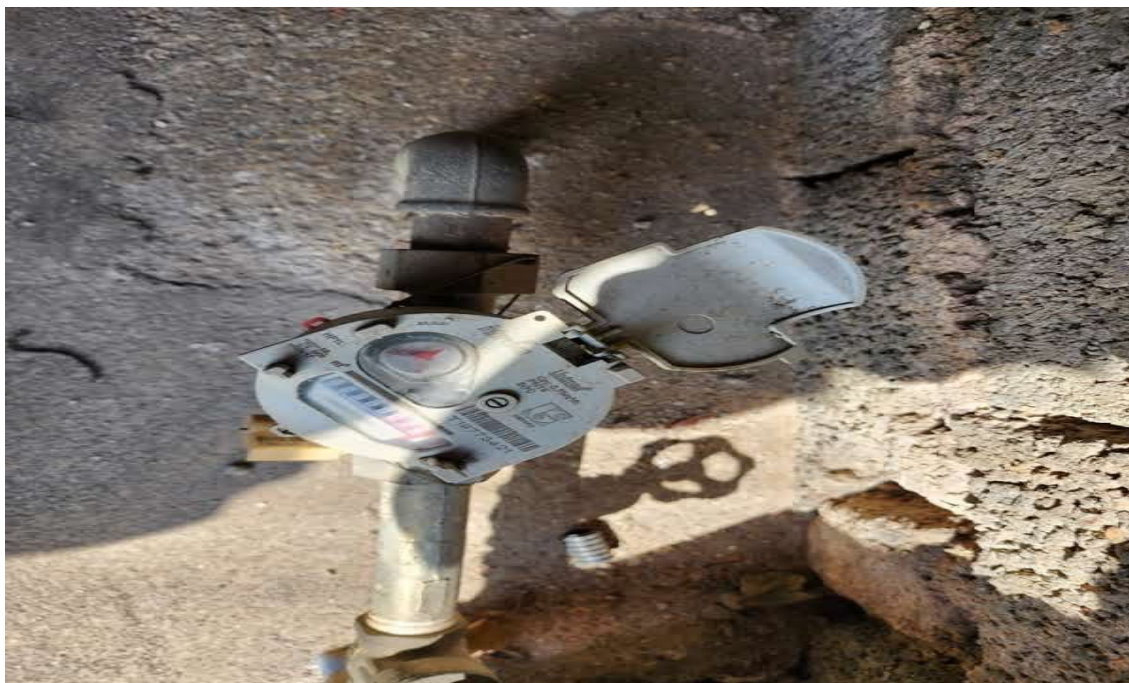
VISTA DO HIDRÔMETRO DO IMÓVEL.
