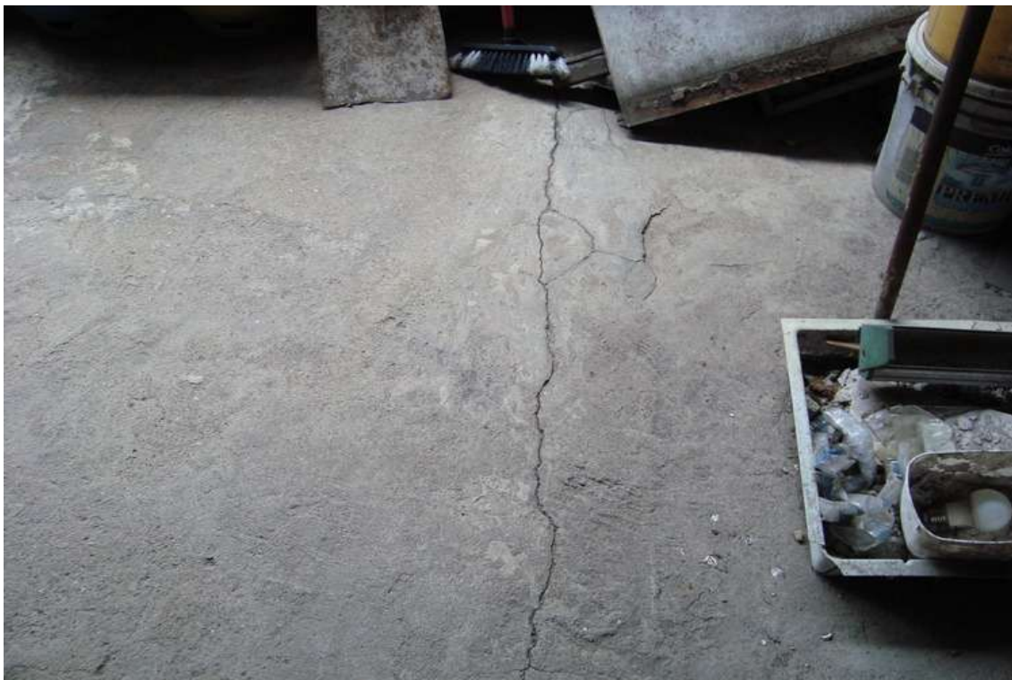
FOTO nº 47 Vista da trinca sobre o piso na cobertura pertencente a Casa nº 01.
