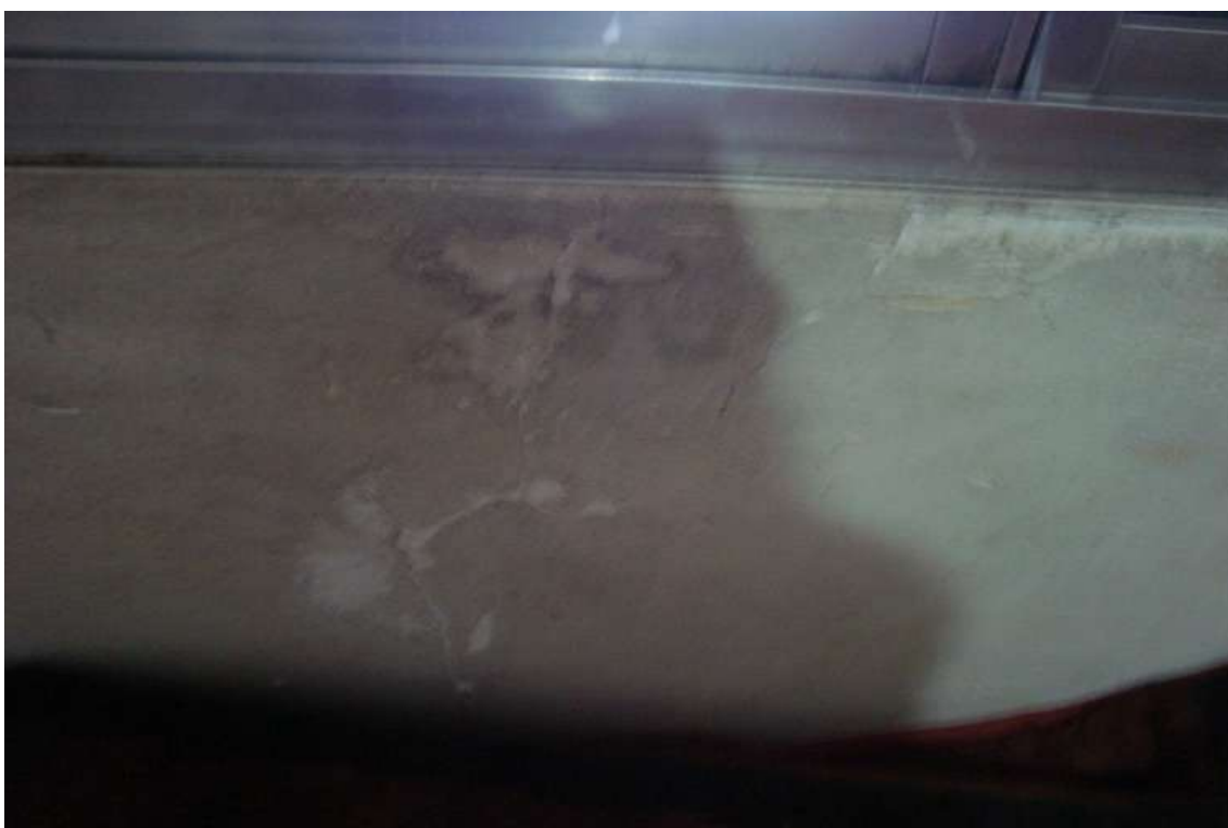
FOTO nº 22 Vista das fissuras e manchas sobre o peitoril da janela no dormitório pertencente a Casa nº 01.
