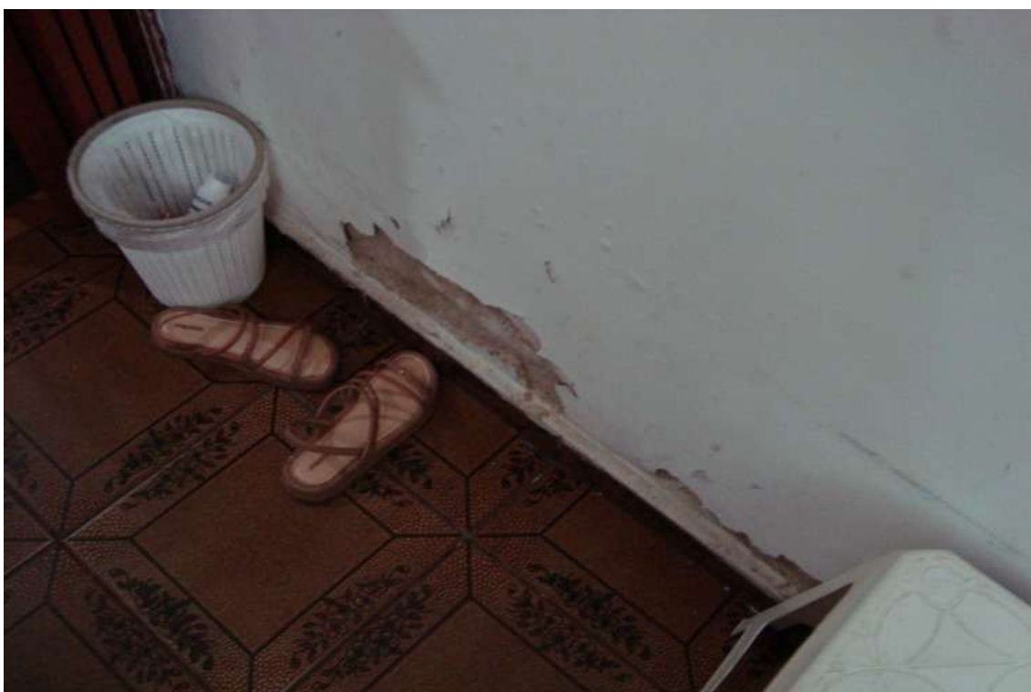
FOTO nº 16 Há descasques sobre o rodapé em parede da sala de estar na Casa nº 01.
