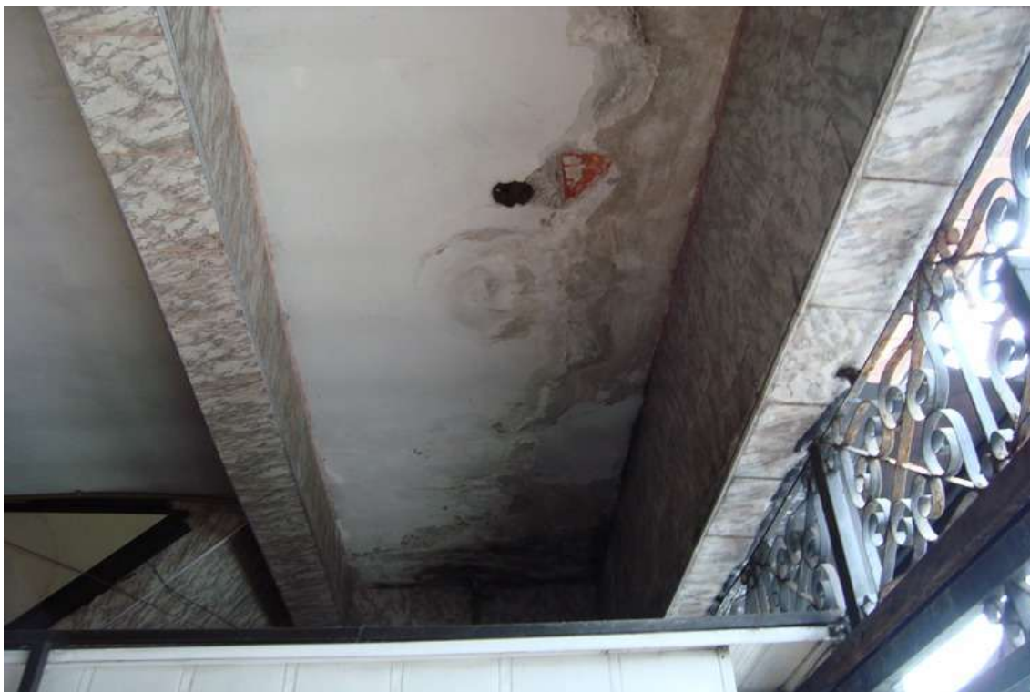
FOTO nº 06 Vista da infiltração d'água no teto pertencente a garagem.
