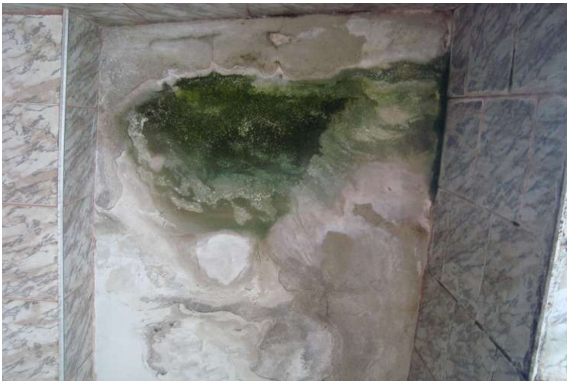
FOTO nº 07 Outra vista da infiltração d'água no teto pertencente a garagem.
