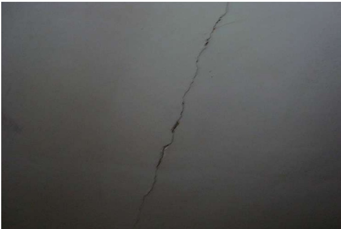
FOTO nº 64 Há trinca sobre o teto no 1º dormitório pertencente a Casa nº 02.
