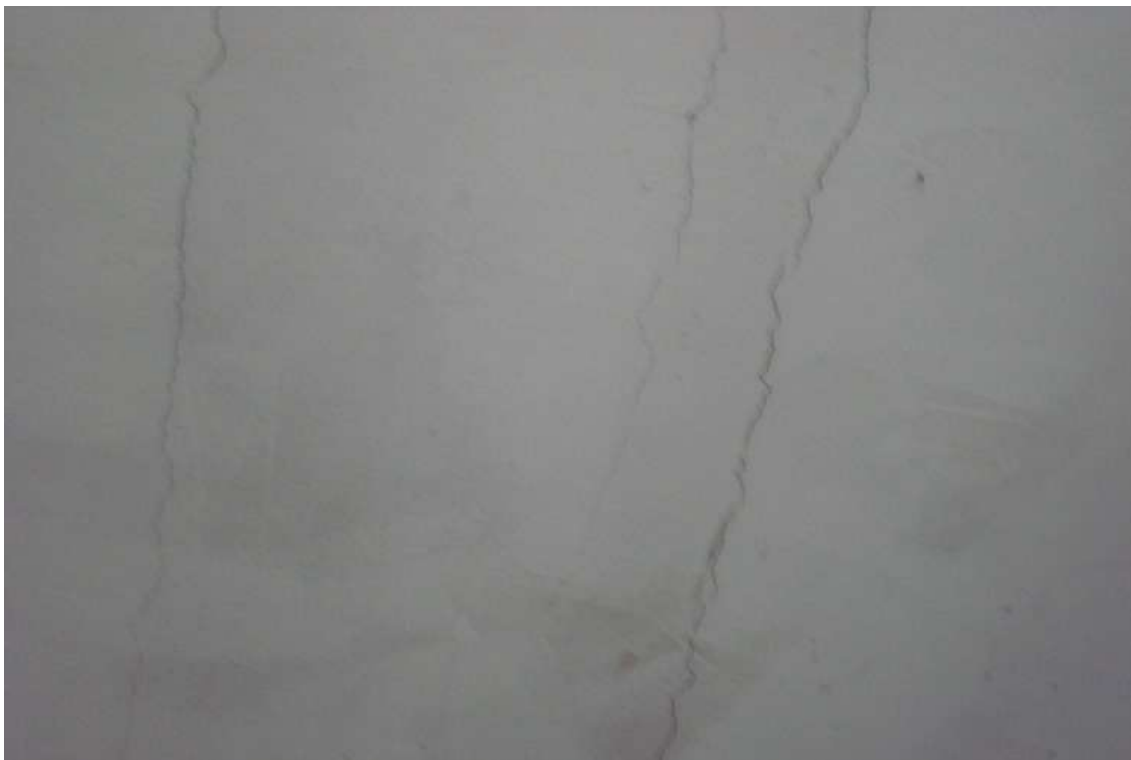
FOTO nº 09 Outra vista das fissuras na laje da garagem.
