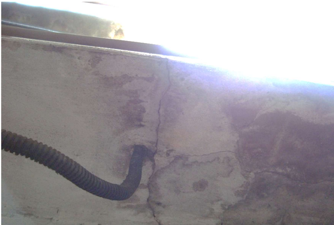
FOTO nº 44 Vista das manchas e fissuras no beiral da Casa nº 01.
