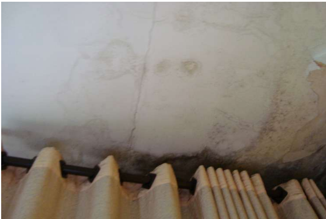
FOTO nº 57 Há fissura no teto da sala de estar na Casa nº 02.
