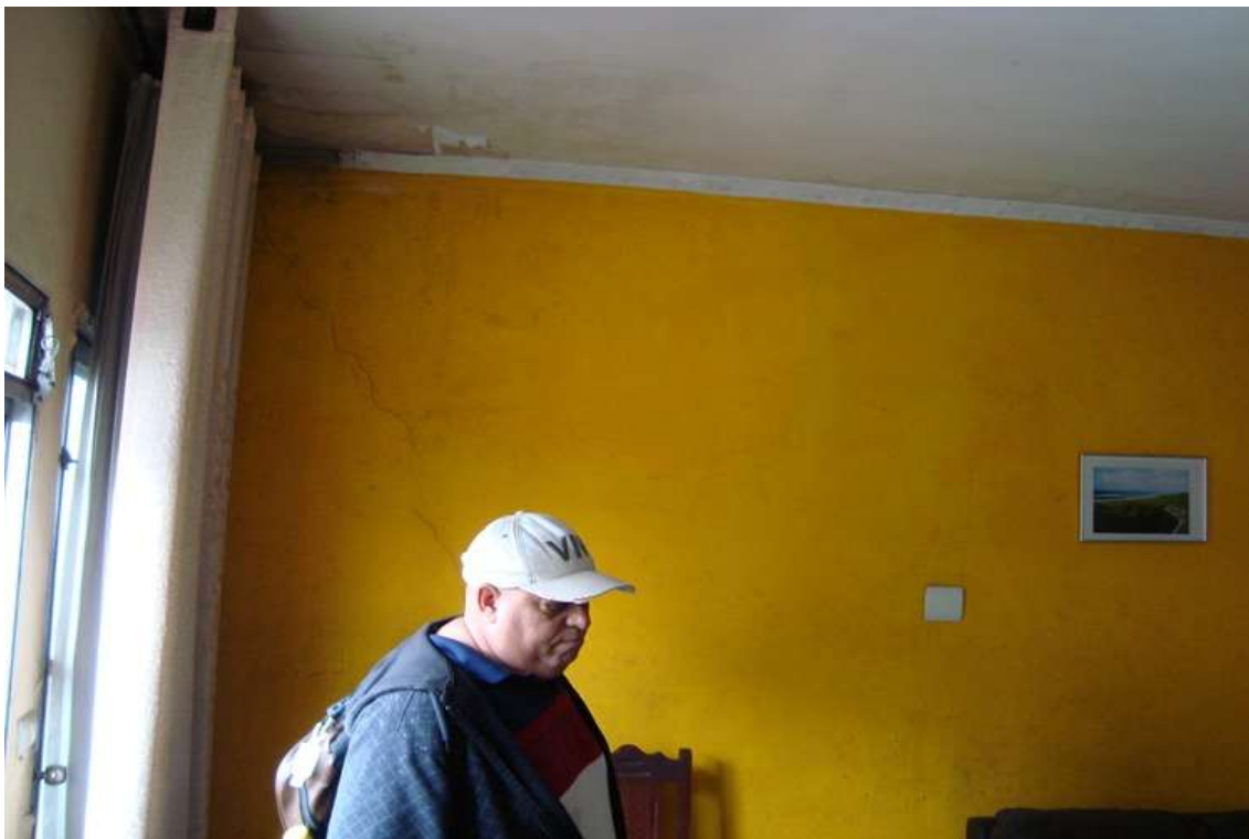
FOTO nº 54 Há fissura em parede na sala de estar da Casa nº 02.
