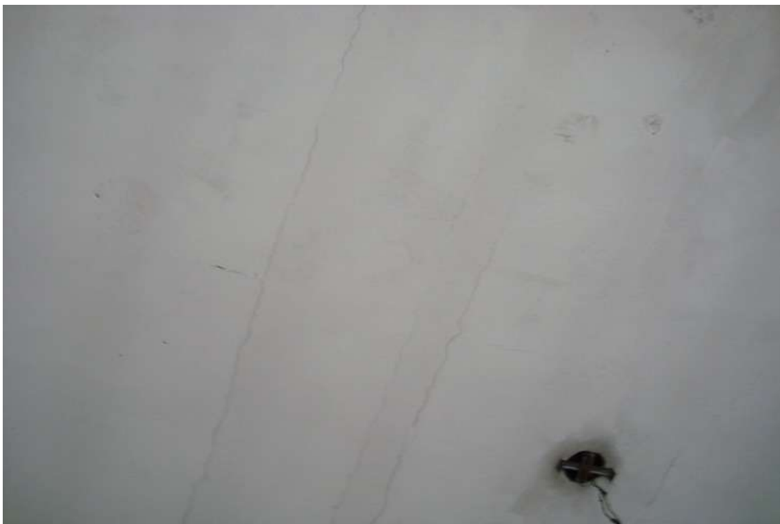
FOTO nº 08 Vista das fissuras na laje da garagem.
